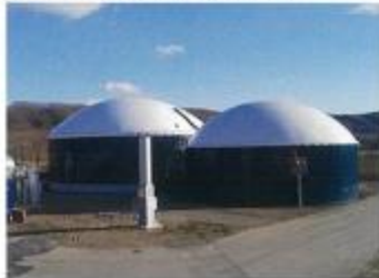
バイオガス発電設備
