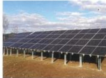
太陽光発電設備
