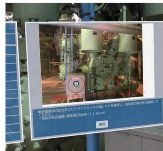
設備に近づくと、自動で確認ポイントや注意事項等のデジタルコンテンツを表示
