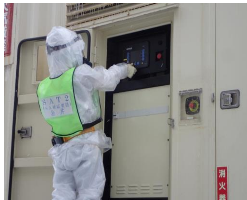
電源車起動訓練
