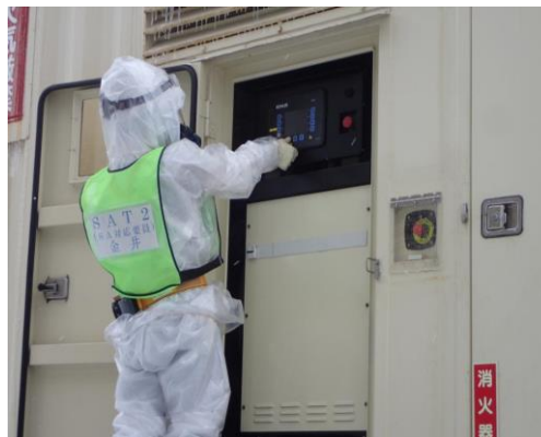
電源車起動訓練
