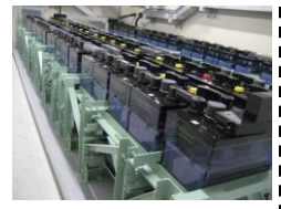
・蓄電池 ・後備蓄電池
