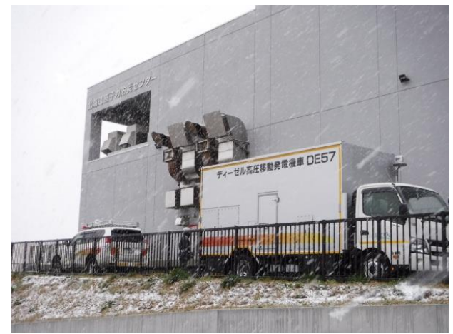
2017年11月15日 オフサイトセンターへの 電源車接続確認訓練
