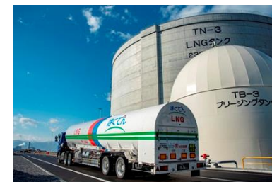
石狩LNG基地のLNGタンクとLNG供給向けタンクローリー
