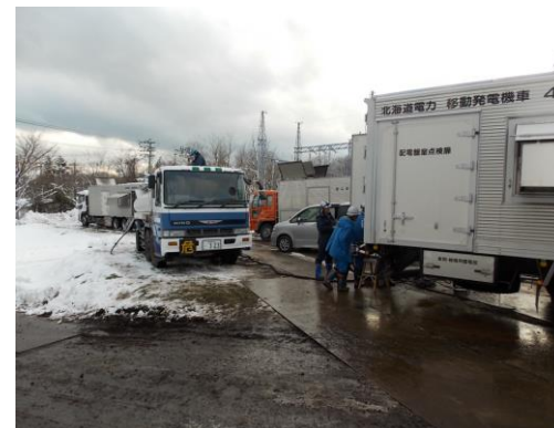
移動発電機車による供給
