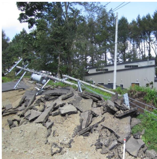
倒壊した柱上変圧器柱
