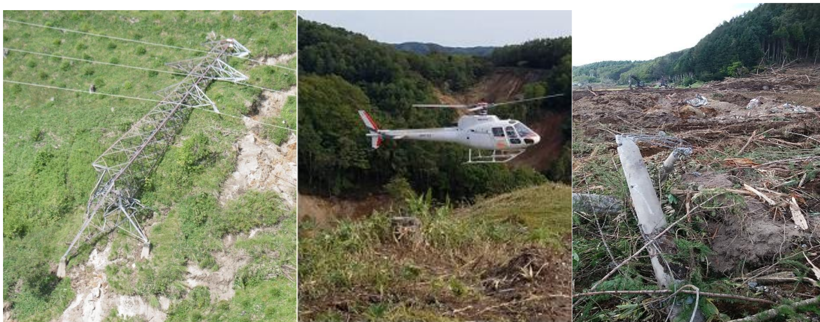
鉄塔倒壊箇所(岩知志線)
