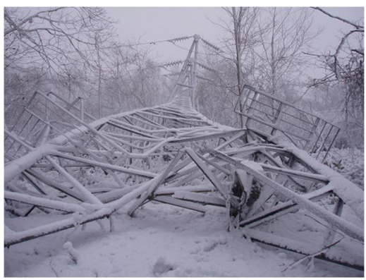
送電線 鉄塔倒壊
