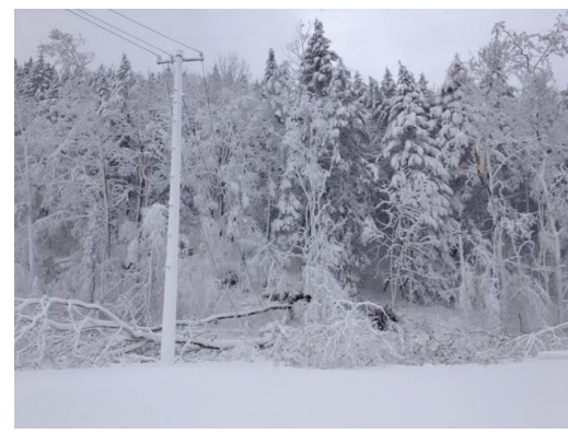
樹木倒壊による 高圧線断線
