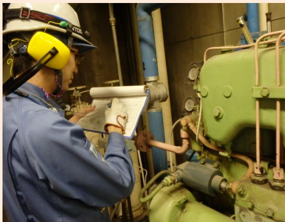
火力発電所運転確認実習(運転員) ディーゼル発電機運転試験
