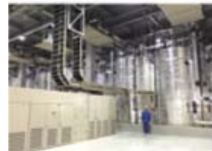
電解液タンク
