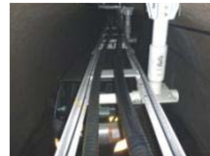
青函トンネル内に敷設した電力ケーブル等
