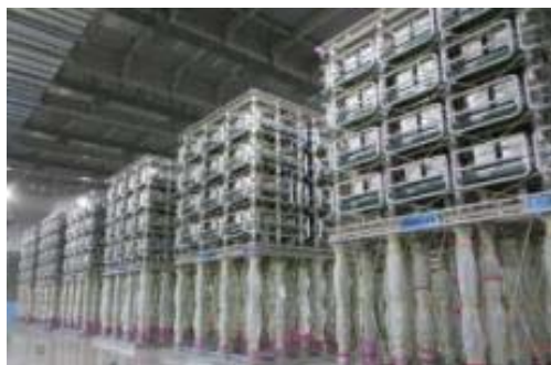
北斗変換所の変換器
