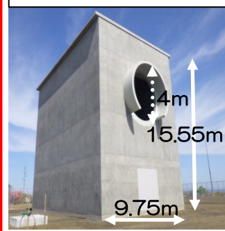
吉岡ケーブルヘッド※1 遮風建屋
