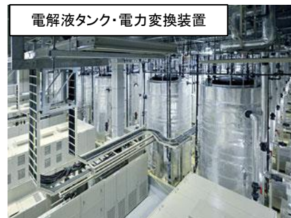
使用する蓄電池はレドックスフロー電池 (定格出力1.5万kW×4時間容量)
