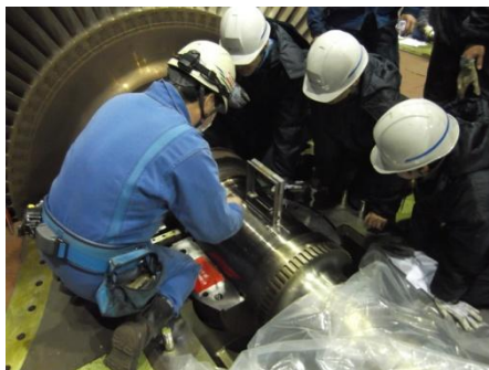
タービン分解点検実習
