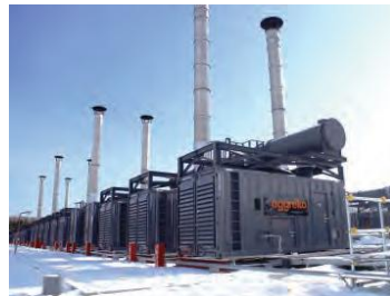
緊急設置電源
