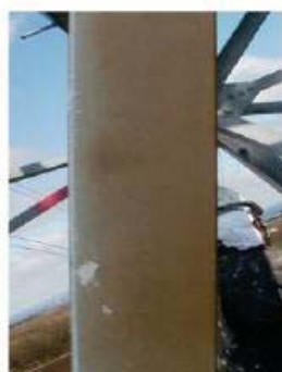
劣化度Ⅲ (メッキ層が薄くなる)
