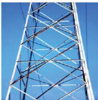
腐食鉄塔の全景
