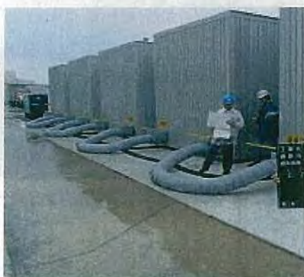
写真 7-6 屋外給水タンク背面ホース
