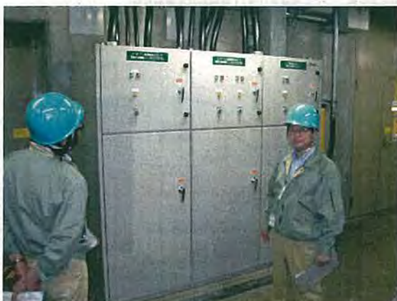
写真 2-13 T/D-AFWP 室前の T/D-AFWP 起動盤
