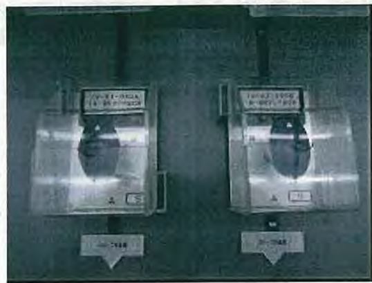
写真 3-2 蓄圧注入系タンクの出口弁スイッチ
