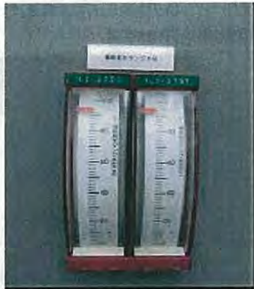
写真 3-1 補助給水タンクの水位計
