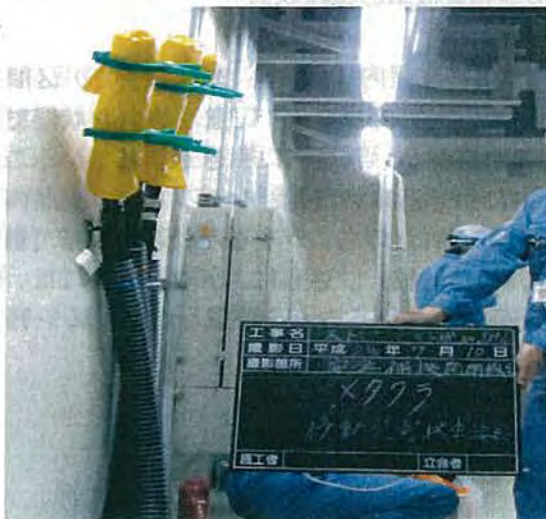
写真 3-18 メタクラ前敷設電源ケーブルの状態
