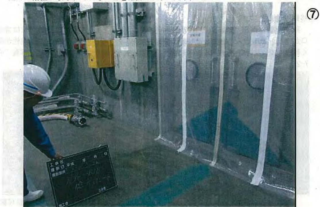
写真 7-5 送水ポンプ車から補助給水タンクへのホース引き込み部
