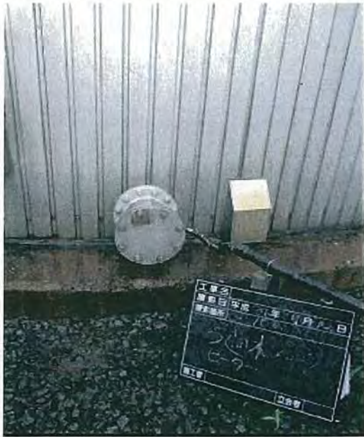
写真 7-8 ろ過水タンクヒータ
