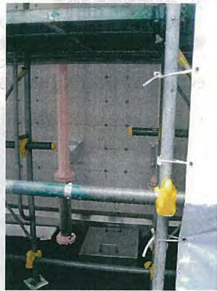
写真 2-11 ベント管（3号機）
