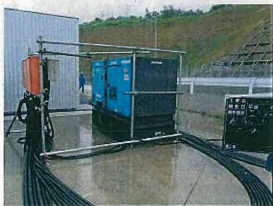
写真 7-7 屋外給水タンクヒータ電源・制御盤
