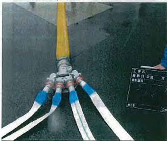
写真 3-25 送水ポンプ車の送水ライン合流部
