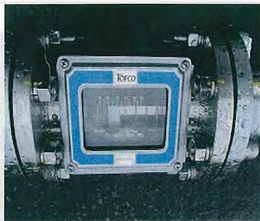
写真 3-28 給水ライン流量計
