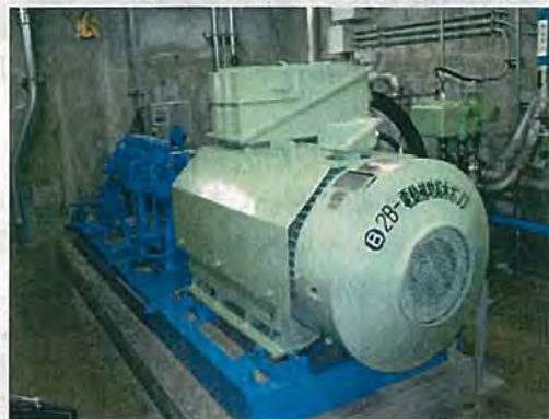
写真 4-2 電動補助給水ポンプ
