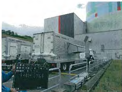
写真 1-1 移動発電機車
