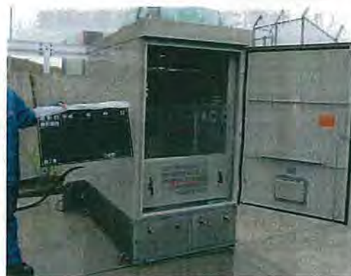
写真 1-2 仮設キュービクル
