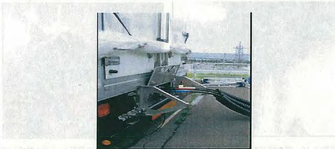
写真 3-13 ケーブルと移動発電機車の接続状態
