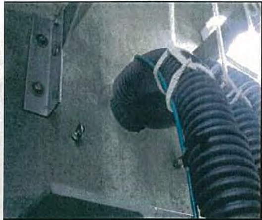
写真 3-17 屋内の電源ケーブル敷設状態
