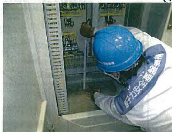
写真 2-14 T/D-AFWP 起動盤の床～配線ダクト距離
