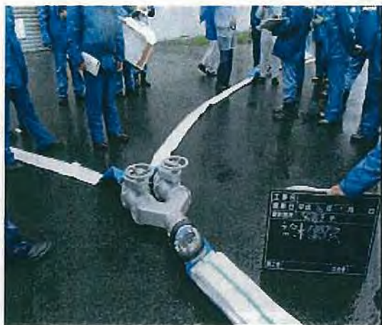
写真 3-27 補助給水タンクと SFP への分岐部
