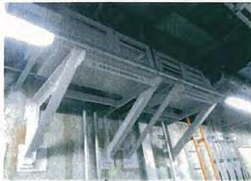
写真 7-9 非管理区域空調機器室電気ヒータ
