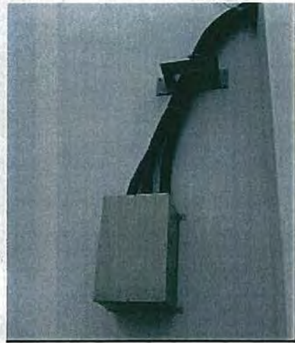
写真 3-15 屋内への侵入部処理
