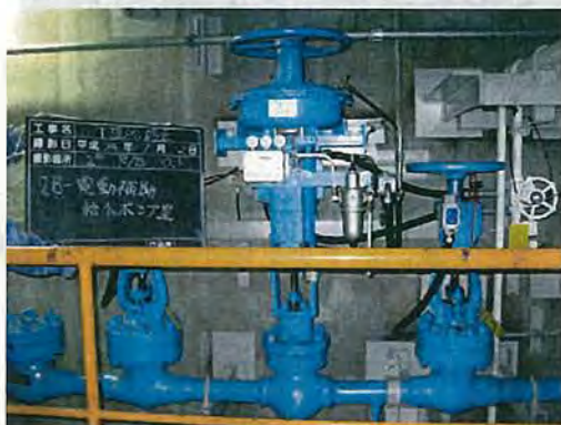
写真 4-1 タービン動補助給水ポンプ 流量調整弁
