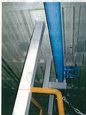
写真 4-3 補助給水系配管のサポート状況 と他の配管干渉状態
