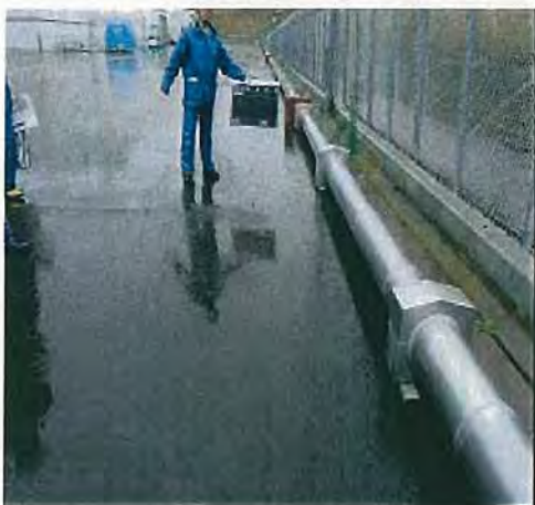
写真 3-29 1, 2 号機用恒設給水ライン
