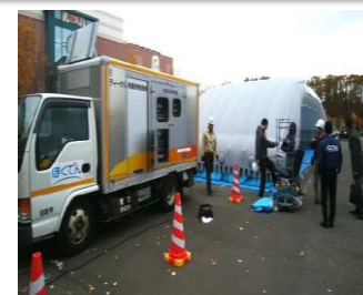
発電機車による電力供給
