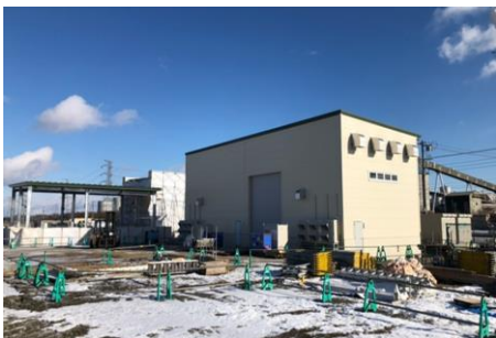
水素製造装置建屋 外観
