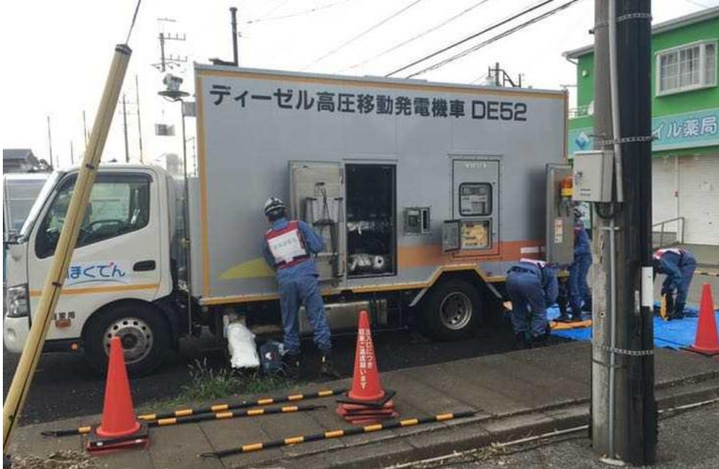
総合病院への応急送電（千葉県八街市）
