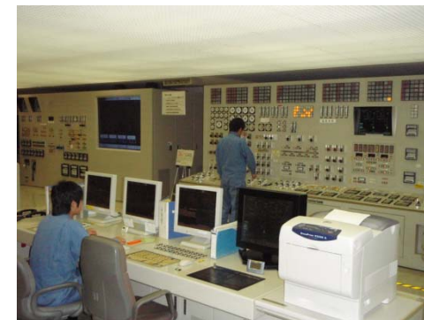
中央操作室での監視状況
