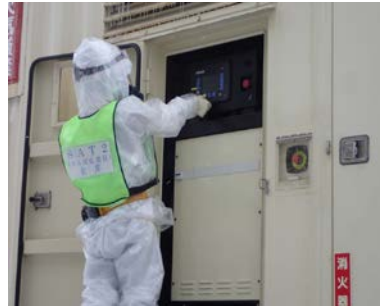
電源車起動訓練
