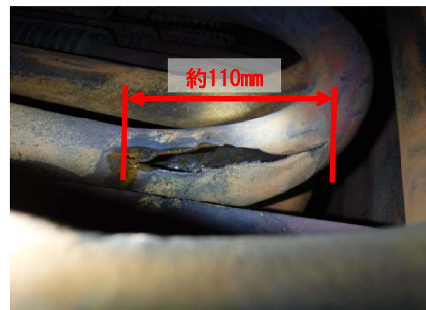
【節炭器管の損傷状況】
