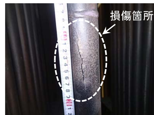
【写真】 再熱器管損傷状況
