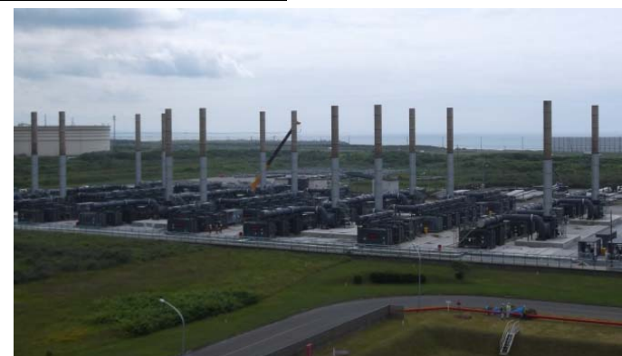
【緊急設置電源（苫小牧発電所）】
