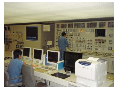
中央操作室での監視状況
