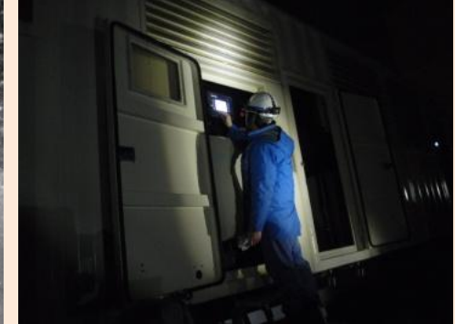
代替給電訓練
