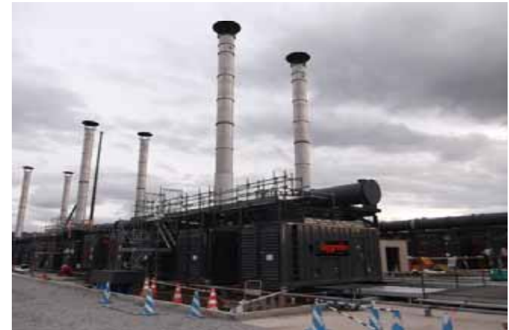
【緊急設置電源（南早来発電所）】
