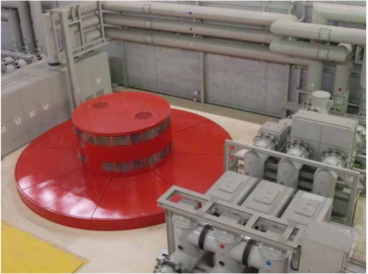
【発電所 1号発電電動機】
