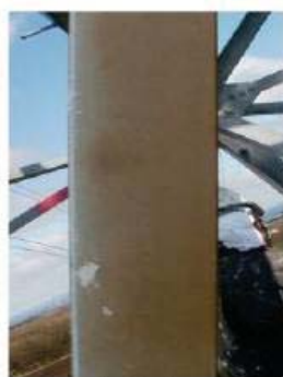
劣化度Ⅲ (メッキ層が薄くなる)
