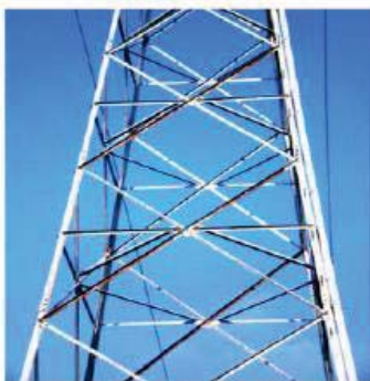
腐食鉄塔の全景
