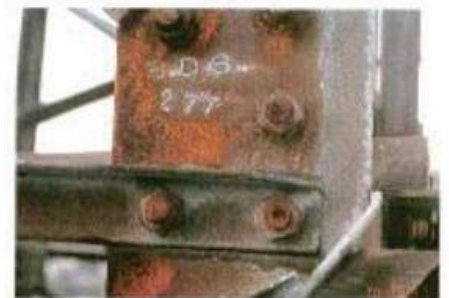
劣化度Ⅳ (メッキ層消失、鉄腐食の進行)
