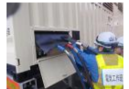
代替給電訓練
