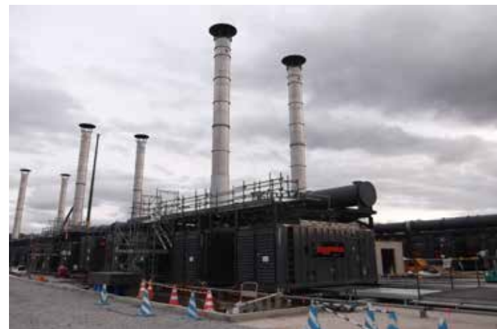
【緊急設置電源（南早来発電所）】
