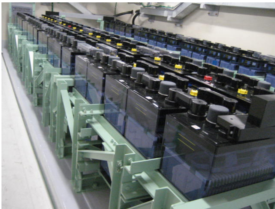
(2) 蓄電池設置状況
