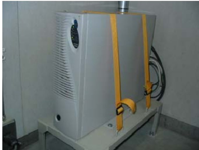
(4) 常設モニタリング設備用非常用発電機
