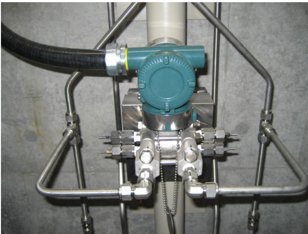
(5) 代替格納容器スプレイ流量積算計の設置状況 (3号機)
