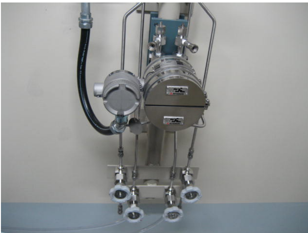
(4) 格納容器スプレイ流量積算計の設置状況 (3号機)
