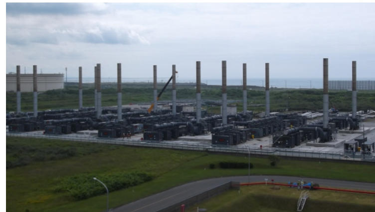
【写真】 苫小牧発電所に設置した緊急設置電源
