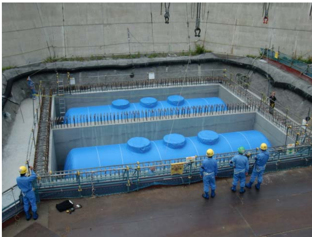
(3) 3号機非常用ディーゼル発電機燃料油貯油槽の設置状況
