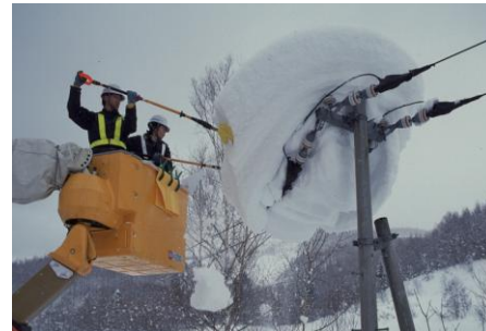
配電設備の冠雪落とし
