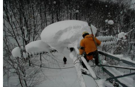
送電設備の冠雪落とし
