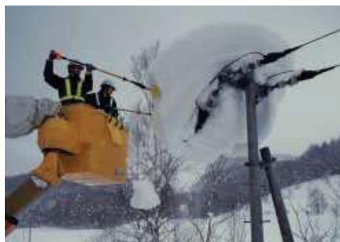
〔配電設備の冠雪落とし〕
