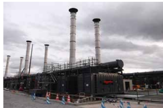
南早来発電所【緊急設置電源】
