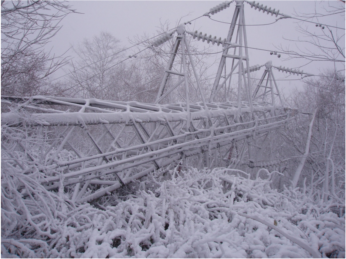
66kV 幌別線 No. 29 鉄塔倒壊状況
