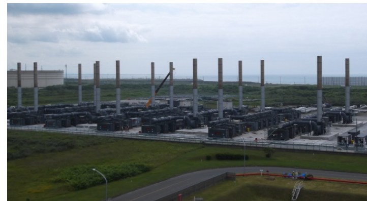
苫小牧発電所に設置した緊急設置電源
