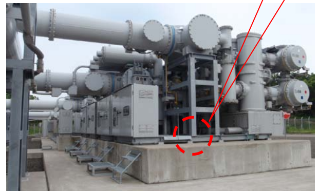
275kV開閉所（1～3号機）写真
