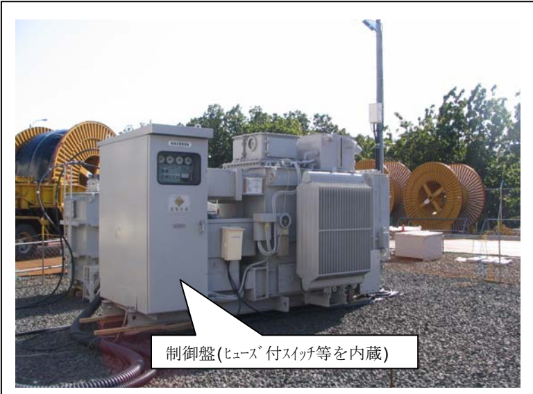
ヒューズ付スイッチ（手前より見た写真）
