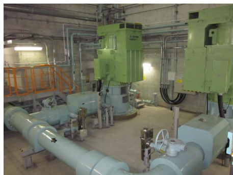
原子炉補機冷却海水ポンプ
