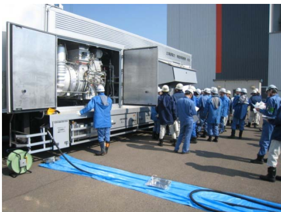
③代替非常用発電機に給油ホースが接続されている状態
