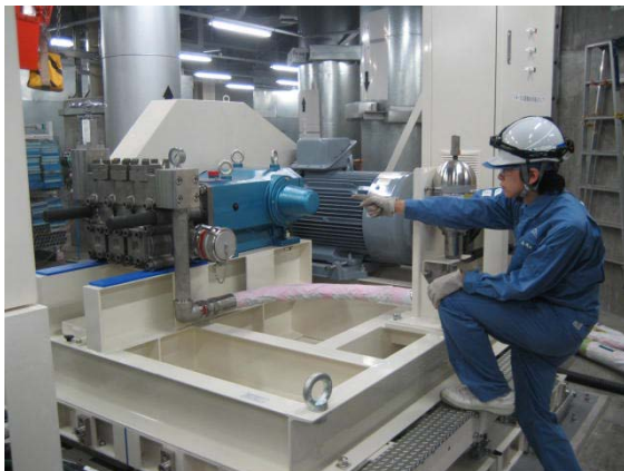
①代替格納容器スプレイポンプのイメージ 写真は、代替格納容器スプレイポンプと同様に 免震架台に設置しているSG直接給水ポンプ
