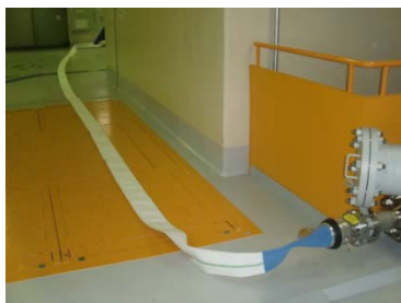
①使用済燃料ピットへの供給ホース敷設状況イメージ 写真は、補助給水ピットへの供給ホース
