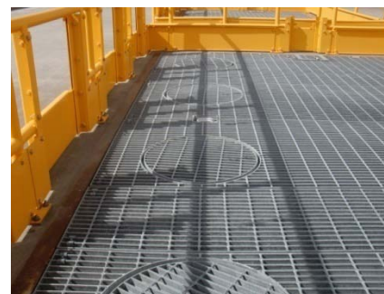
⑧送水ポンプ車取水場所 スクリーン室上部グレーチング
