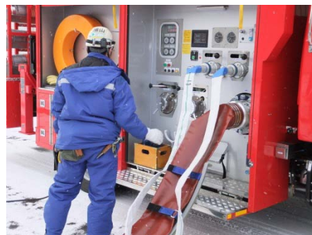
①送水ポンプ車操作盤
