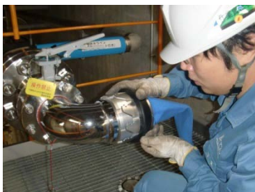
①補助給水ピットへの供給ライン接続
