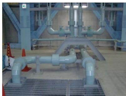
⑦海水供給ラインホース接続箇所
