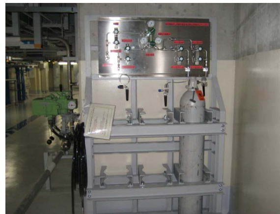
①窒素ガスボンベのイメージ 写真は、加圧器逃がし弁用窒素ガスボンベ
