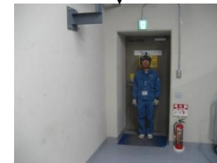
⑦安全補機開閉器室①
