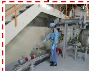
⑧代替格納容器スプレイポンプ接続ライン(設置予定箇所)
