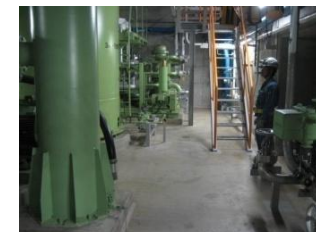
④原子炉補機冷却水サージタンクエリアから制御用空気圧縮機室へ
