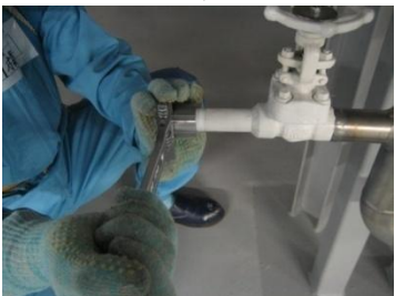
⑤加圧器逃がし弁側ねじ込み式 キャップ取外し
