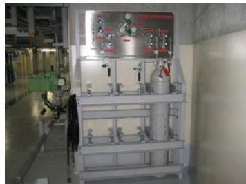
①窒素ガスボンベのイメージ 写真は、加圧器逃がし弁用窒素ガスボンベ
