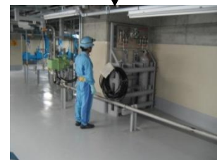
⑧加圧器逃がし弁操作用可搬 式窒素ガスポンペエリア
