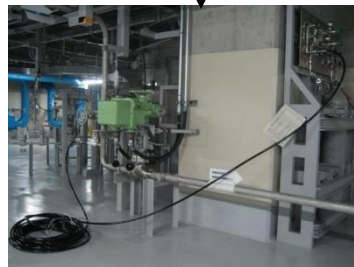
④窒素ガスボンベのホース接続イメージ 写真は、加圧器逃がし弁用窒素ガスボンベ
