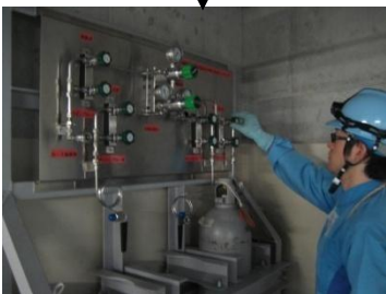
⑥窒素ガスボンベからの窒素供給操作 (バルブパネル操作) 写真は、加圧器逃がし弁用窒素ガスボンベ
