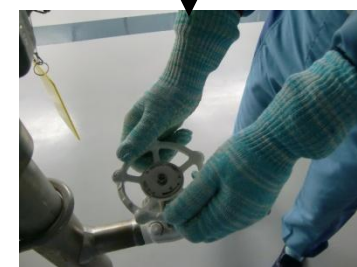
⑪窒素ガスボンベからの窒素供給 操作(系統側バルブ操作)
