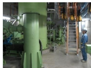
⑤制御用空気圧縮機室
