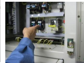
⑦6. 6kVメタクラ しゃ断器投入操作イメージ
