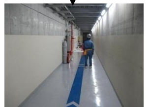
③原子炉補助建屋内、A-D 階段入口扉へ移動
