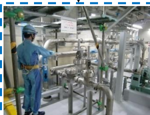
⑥燃料取替用水ポンプエリアへ(設置予定箇所)
