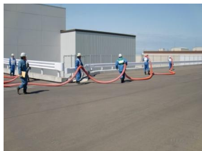
31m盤ホース敷設状況 (カップラティブではあるが、消 防ホースではない)
