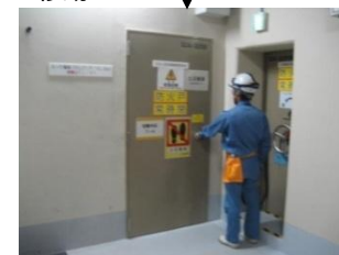
⑥安全補機開閉器室入口扉
