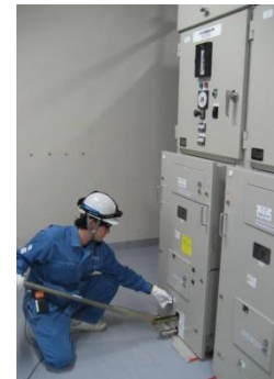
⑥6. 6kVメタクラ しゃ断器接続操作イメージ
