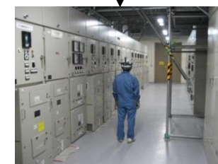
⑧安全補機開閉器室②
