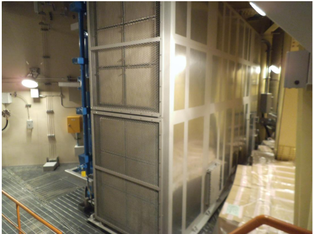
格納容器再循環ユニット
