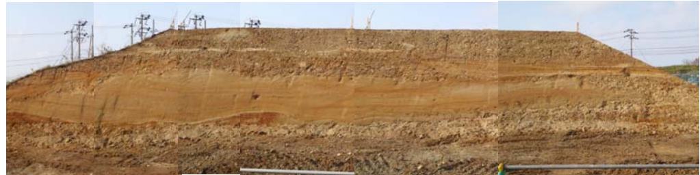
①敷地内の岩内層露頭写真(堆積構造が把握可能)
