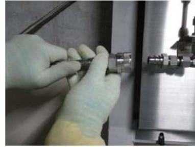
アニュラス全量排気弁等操作用可搬型窒素ガスポンペのカプラ接続 (周辺補機棟 T. P. 40. 3m)
