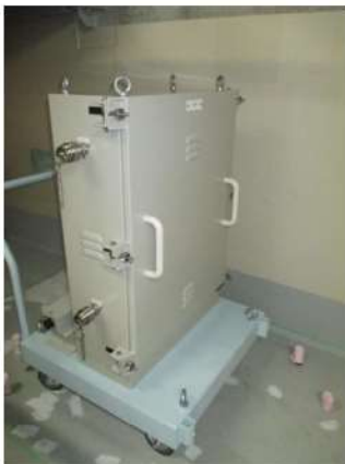
可搬型アニュラス水素濃度計測ユニット (周辺補機棟 T. P. 24. 8m)
