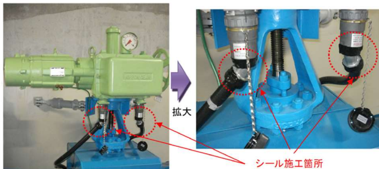
図5-6 被水対策状況
