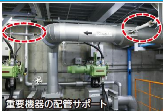
重要機器の配管サポート
