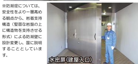
水密扉 (建屋入口)
